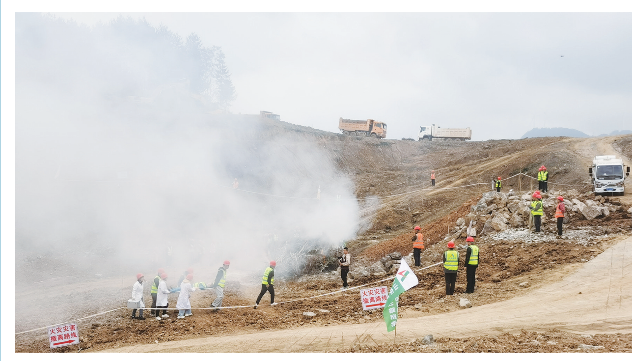
日前,2023年度交通建设项目森林火灾扑救暨地质灾害避险综合应急演练在朝天区麻柳乡石板村黑石坡至曾家山公路(下称黑曾路)工程建设项目部5号拌和站组织开展。演练设置森林火灾扑救和地质灾害避险演练2个科目。演练现场,模拟黑曾路项目主线施工队人员在某施工点发现该处“森林”突发火情,项目部施工队立即报告并进行扑救,因火势无法控制,前方指挥部调度项目部及公司应急扑火队、应急小队联合扑救,最终火势被成功扑灭。梁慧芳 孙春梅 摄
