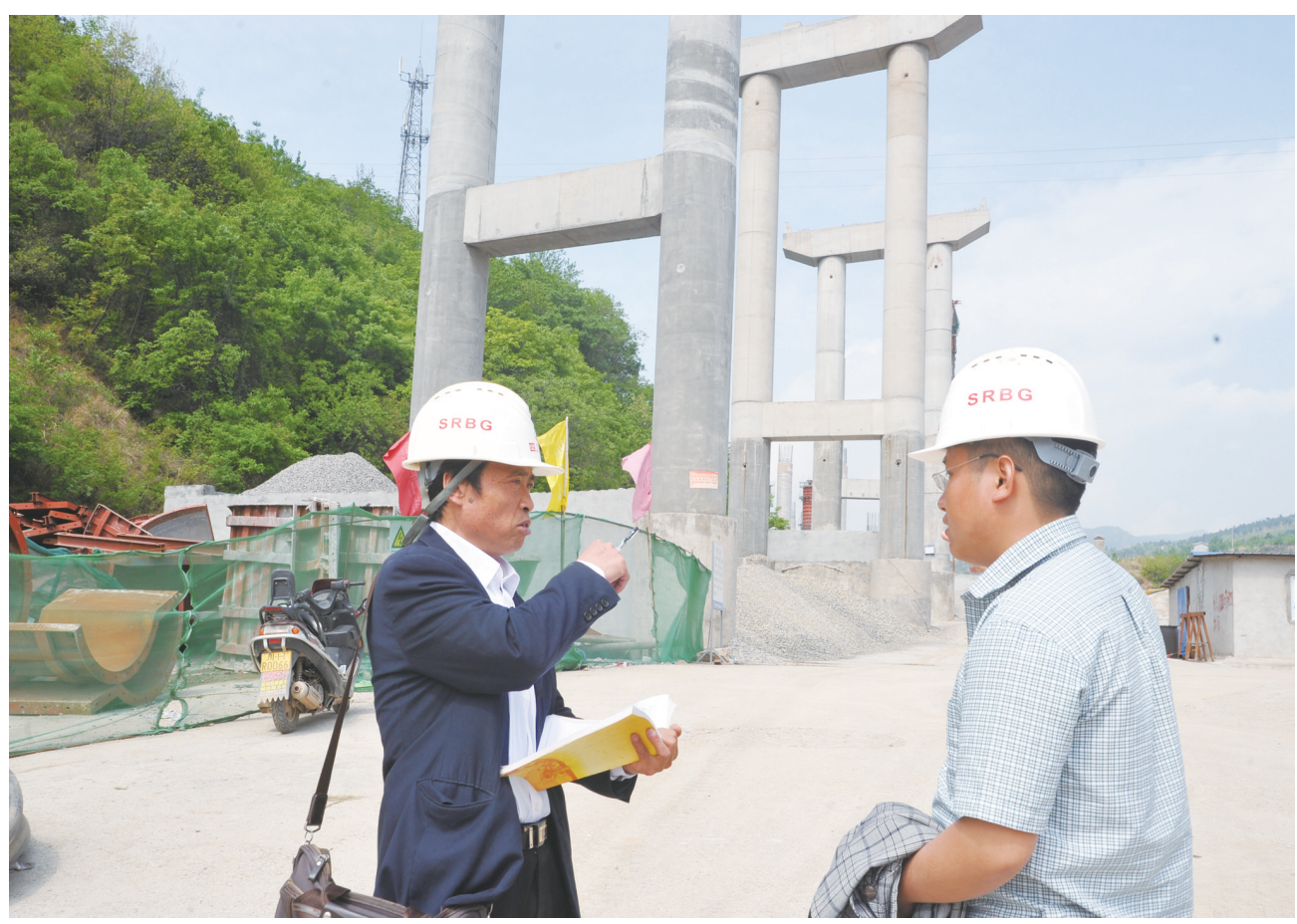
西安至成都客运专线在广元市境内长度约为103公里,建成通车后,西安与成都将形成“2.5小时交通圈”,途经我市青川县、剑阁县、利州区、朝天区。利州区红线占地834亩,目前已交付使用725亩,农房红线内需拆迁165户,已拆迁130户。企业需拆迁18家,已拆迁11家。自前年开工以来,工程进展顺利。图为5月11日记者拍摄的回龙河街境内高架桥施工现场。 本报记者 彭富 摄
