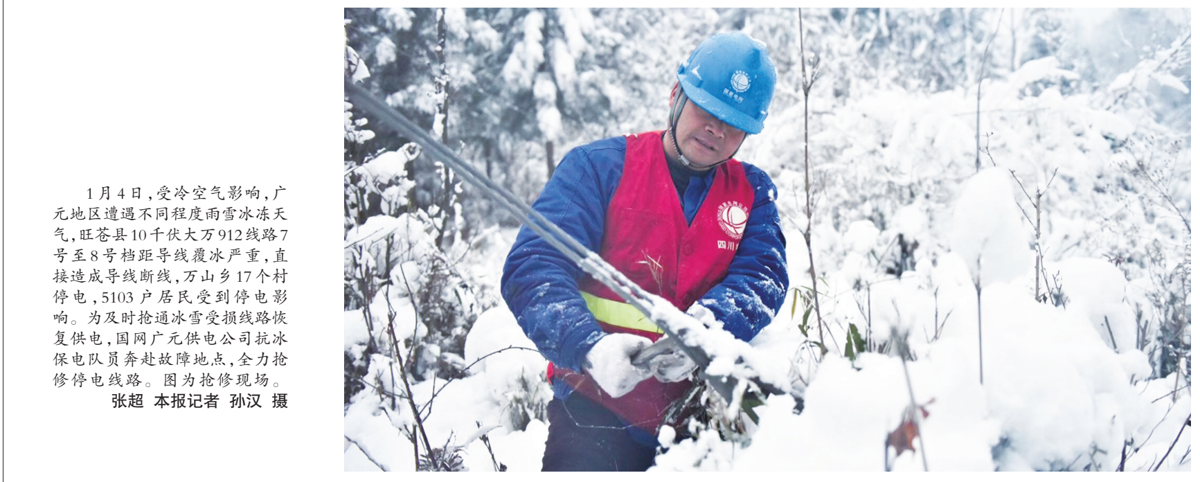
1月4日,受冷空气影响,广元地区遭遇不同程度雨雪冰冻天气,旺苍县10千伏大万912线路7号至8号档距导线覆冰严重,直接造成导线断线,万山乡17个村停电,5103户居民受到停电影响。为及时抢通冰雪受损线路恢复供电,国网广元供电公司抗冰保电队员奔赴故障地点,全力抢修停电线路。图为抢修现场。
