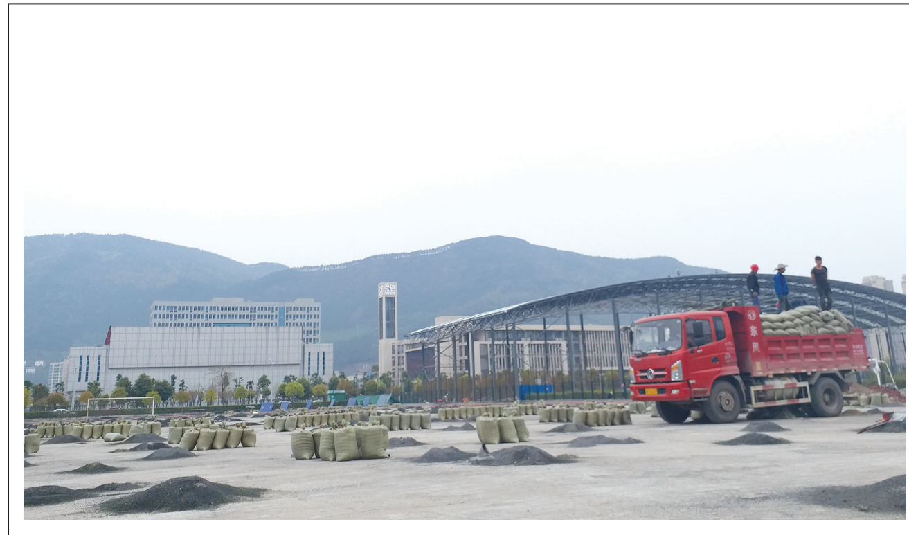
位于澳源体育中心内的室外足球场面积10000平方米,升级改造后的室外足球场将更换全新的人工草坪,预计完工时间为4月30日。目前,足球场正重新铺装。图为3月26日的施工现场。 本报记者 赵雪洋 摄
