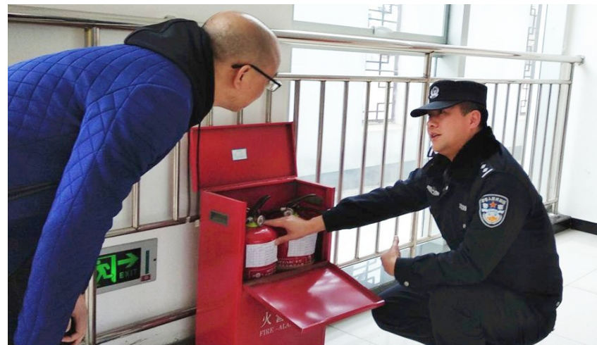
新春佳节临近，汽车销售行业生意兴隆，但部分汽车4S店消防安全隐患突出。为切实加强辖区汽车4S店消防安全管理工作，增强汽车销售人员的消防安全意识和逃生自救能力，1月7日，经开区公安分局针对性组织辖区14家汽车4S店开展一场消防演练。民警对汽车4S店负责人详细讲解了消防安全知识、灭火等救援常识，现场指导企业员工正确使用灭火器材，遇到火灾时如何应对、如何救护伤员等。同时模拟演练了场地、物资和车辆火灾中报警、初火扑灭等场景，为确保辖区消防安全打下了坚实基础。图为检查消防设备。 本报记者 孙汉 摄
