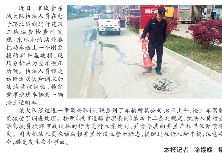
近日,市城管东大队执法人员在电子路北延线进行建筑工地巡查检查时发现:东环加油站外非机动车道上一个刚更换的新井盖破损,现场分析应为重车碾压所致。执法人员经走访附近居民和调取加油站监控视频,锁定肇事逃逸车辆为一辆渣土运输车。该大队经过进一步调查取证,联系到了车辆所属公司,8日上午,渣土车驾驶员接受了调查处理。按照《城市道路管理条例》第四十二条之规定,执法人员对当事驾驶员损坏市政设施的行为进行立案处罚,并责令其向井盖产权单位赔偿损失。图为执法人员在该破损井盖处设立警示标志,提醒过往行人和车辆,注意安全,避免发生安全事故。
