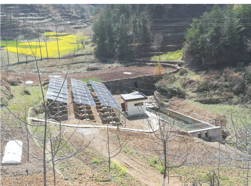
提灌站内,发电总功率45.6KW的太阳能给予全胜村生产用水的电力保障。
