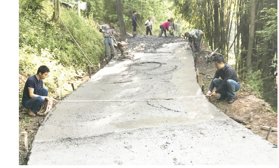
4月26日,在旺苍县化龙乡长乐村二组村民入户路施工现场,该县县委编办驻村工作队和当地村“两委”干部忙着查看并监督工程进度及质量。今年以来,该县委编办驻村工作队帮助化龙乡长乐村协调落实4公里入户路硬化项目,尽力帮助该村部分群众解决出行难的问题。图为该办驻村工作队队员和村干部实地查看并监督工程进度和质量。李永辉 本报记者 周俊 摄
