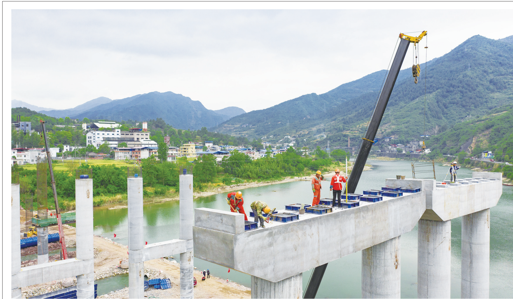
省重点重点项目G542旺苍县城嘉川至东河段公路工程,全长19.18公里,总投资16.54亿元,2019年1月开工,建设工期36个月。东河大桥是重要节点工程之一,全长658.5米。截至目前,河床下部完成70%,其中桩基完成23根,墩柱完成10根,盖梁完成一座。 图为航拍5月3日建设者们放弃“五一”假期休息,坚守岗位加快工程建设进度。 陈加普 摄
