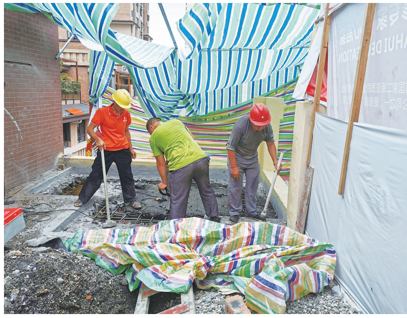
8日,利州区综合行政执法局东坝中队对老街社区阆山3-5-501违法搭建(构)筑物进行拆除,拆除面积为15平方米。图为拆除现场。
