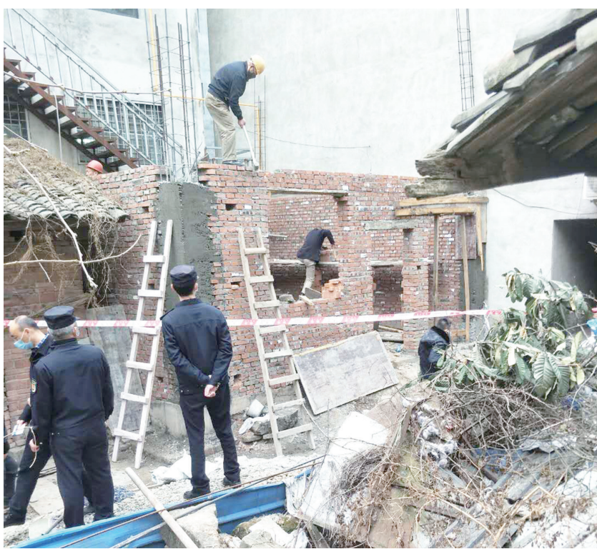
13日,利州区综合行政执法局大石中队联合万缘中队对大石社区三组违法修建房屋进行拆除,拆除面积30平方米。图为拆除现场。本报记者 赵雪洋 摄
