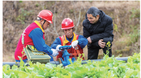
好雨知时节，当春乃发生。2月22日，国网广元供电公司羊木供电所员工冒雨在田间地头对春耕生产用电设备进行特巡检查，处理用电隐患。
