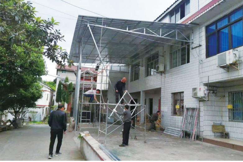
4月3日，利州区河西街道同心村二组有村民擅自违法搭建彩钢棚，面积约80平方米。利州区综合行政执法局河西中队执法人员现场制止并责令该住户立即停工，要求限期自行拆除。 图为该住户违法搭建的彩钢棚。
